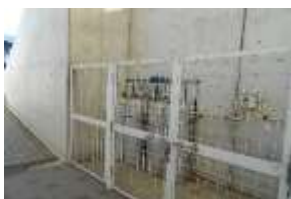
① ポンベ庫
