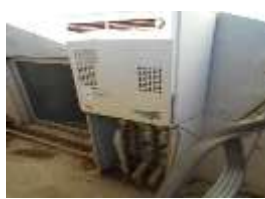
② 給湯設備
