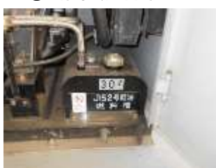
② 備蓄燃料槽
