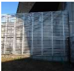
① 受水槽（外観）
