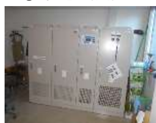
③ 蓄電池設備
