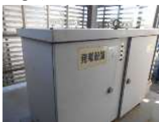
① 非常用発電機
