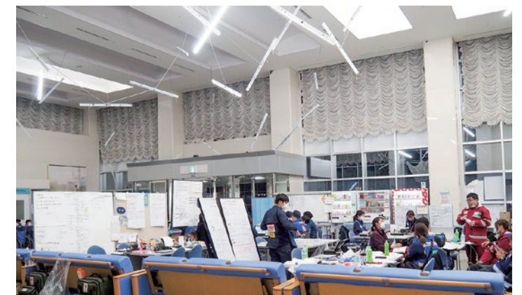
天井の照明が剥落する中で業務を行う様子(輪島病院)
