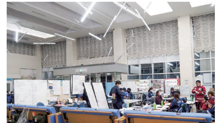
天井の照明が剥落する中で業務を行う様子(輪島病院)
