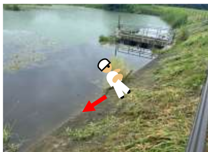
(ため池堤体の急傾斜)
