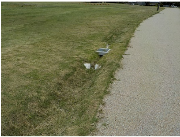
図5-7 園路脇の排水路整備の事例 (岐阜県関市 弥勒寺官衙遺跡群)
