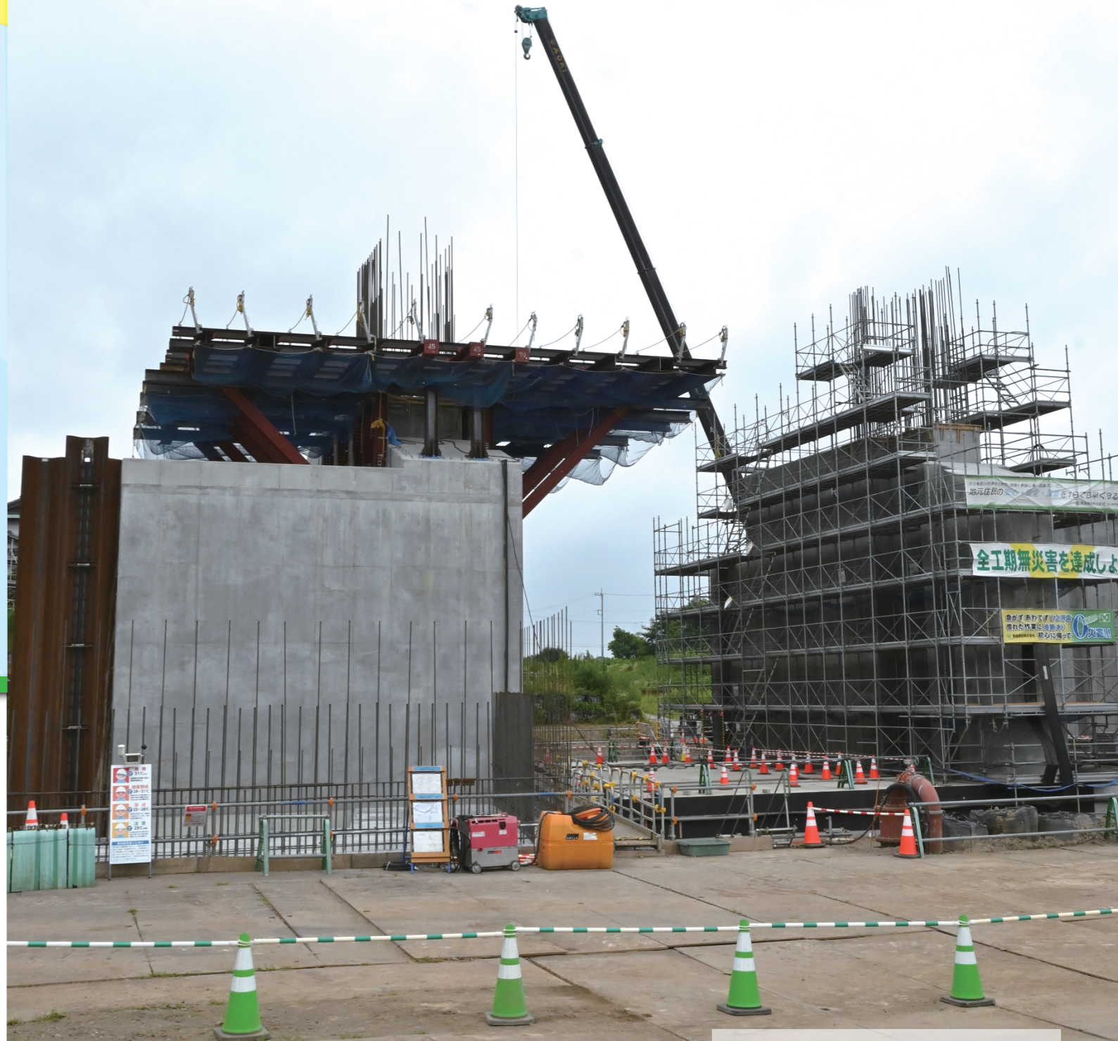
PHOTO 田川水門(仮称) 鬼怒川と田川の合流地点(久保田地内)に建設中の 水門です。水害から私たちの暮らしを守ります。
