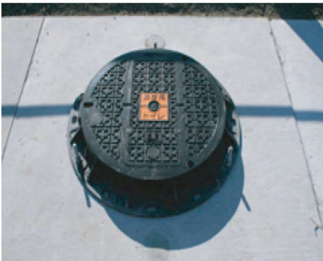
■マンホール付便槽
