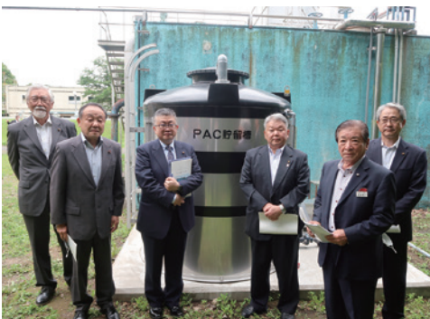
本町浄水場 調査内容：PAC注入設備について
