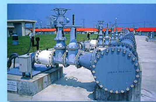
▲配水池に溜めた水に配水ポンプで圧力をかけ、必要な量だけ送り出します。
