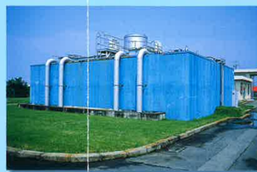
▲急速ろ過池で鉄やマンガン、浮遊物を取り除きます。
