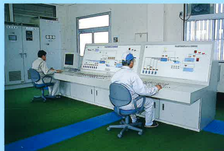
▲浄水場の設備を1か所で監視できる電気計装室。
