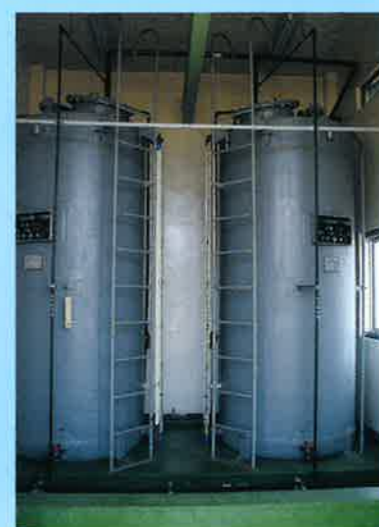
▲次亜塩素酸ソーダを加えて水を消毒するポンペ室。
