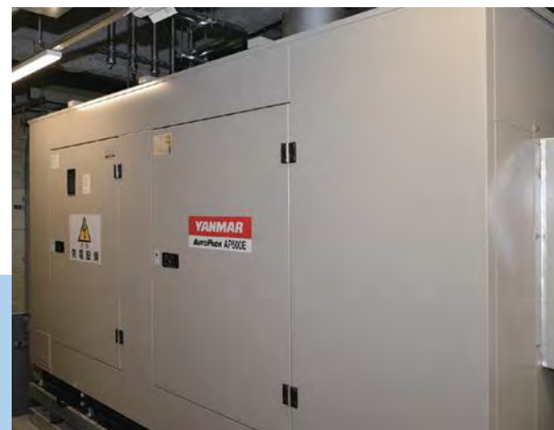
非常用発電装置
