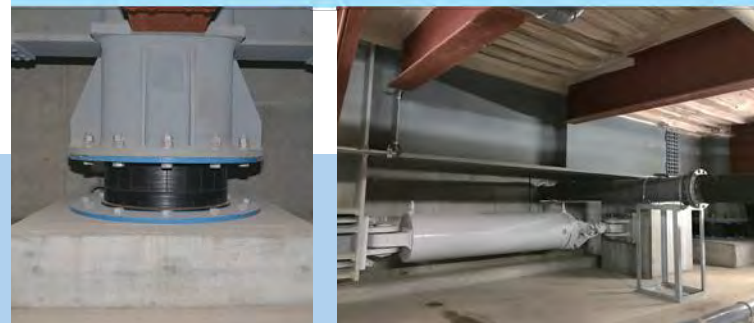
免震装置と免震ダンパー
