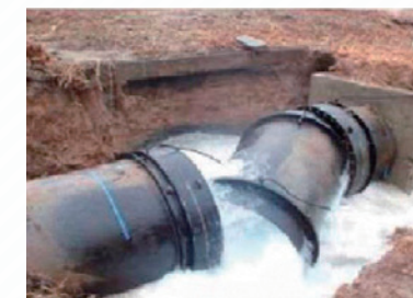
東日本大震災における継手離脱
