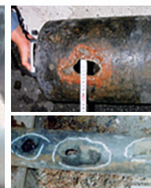
老朽化した水道管
