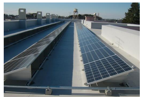
太陽光発電システム（結城小学校） ▶
