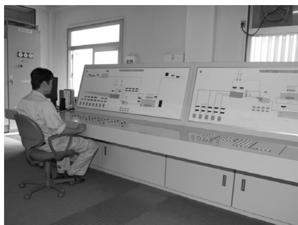
□ 林浄水場（監視室）
